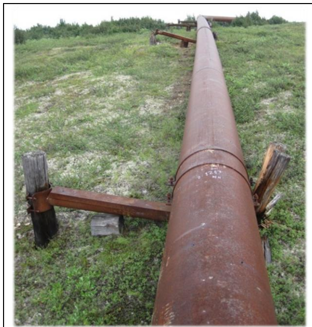
Рис. 1. Разрушение нескольких, идущих подряд, опор газопровода
