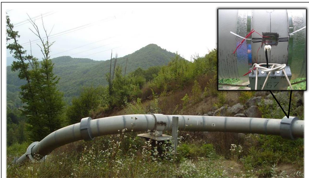
Рис.9. Измерительный блок и датчики, установленные на участке
